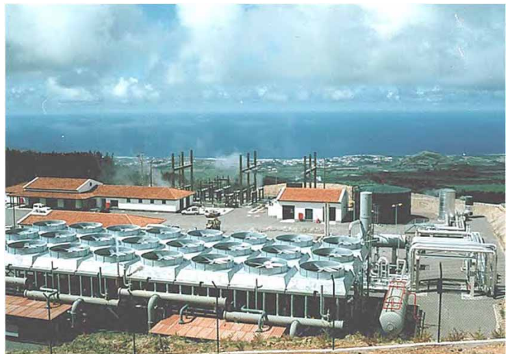
Vista geral da central geotérmica da Ribeira Grande Em primeiro plano, a bateria de condensadores General view of the Ribeira Grande Geothermal Plant Foreground: the condenser yard
