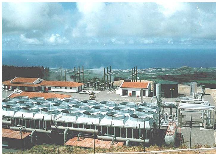
Vista geral da central geotérmica da Ribeira Grande Em primeiro plano, a bateria de condensadores
