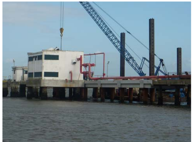
Depois de concluídos os trabalhos de reabilitação After conclusion of the rehabilitation works
