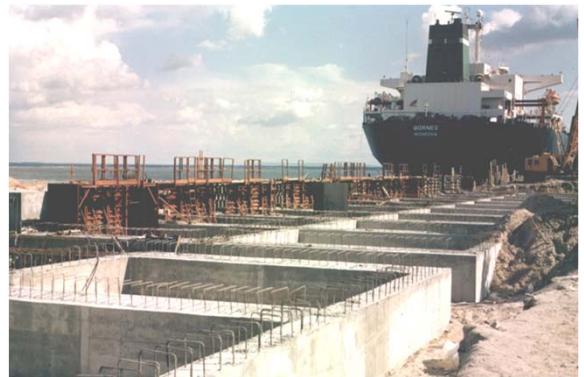
Aspecto dos trabalhos de ampliação do Cais 3 General view of the Pier 3 Extension works
