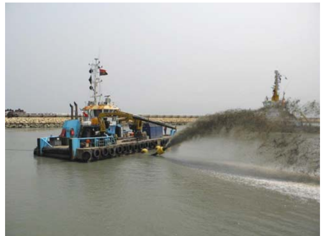
Zona das dragagens durante os trabalhos Zone of dredging during the works
