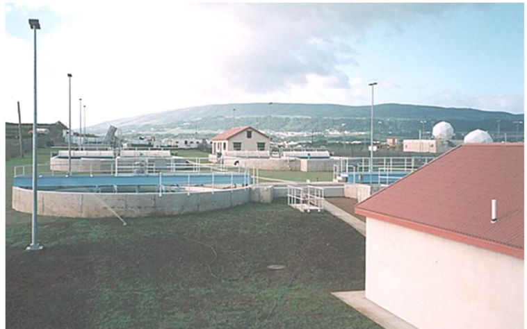
Vista geral da ETAR. Em segundo plano, os tanques de clarificação General view of the WWTP. Background: the clarifier tanks
